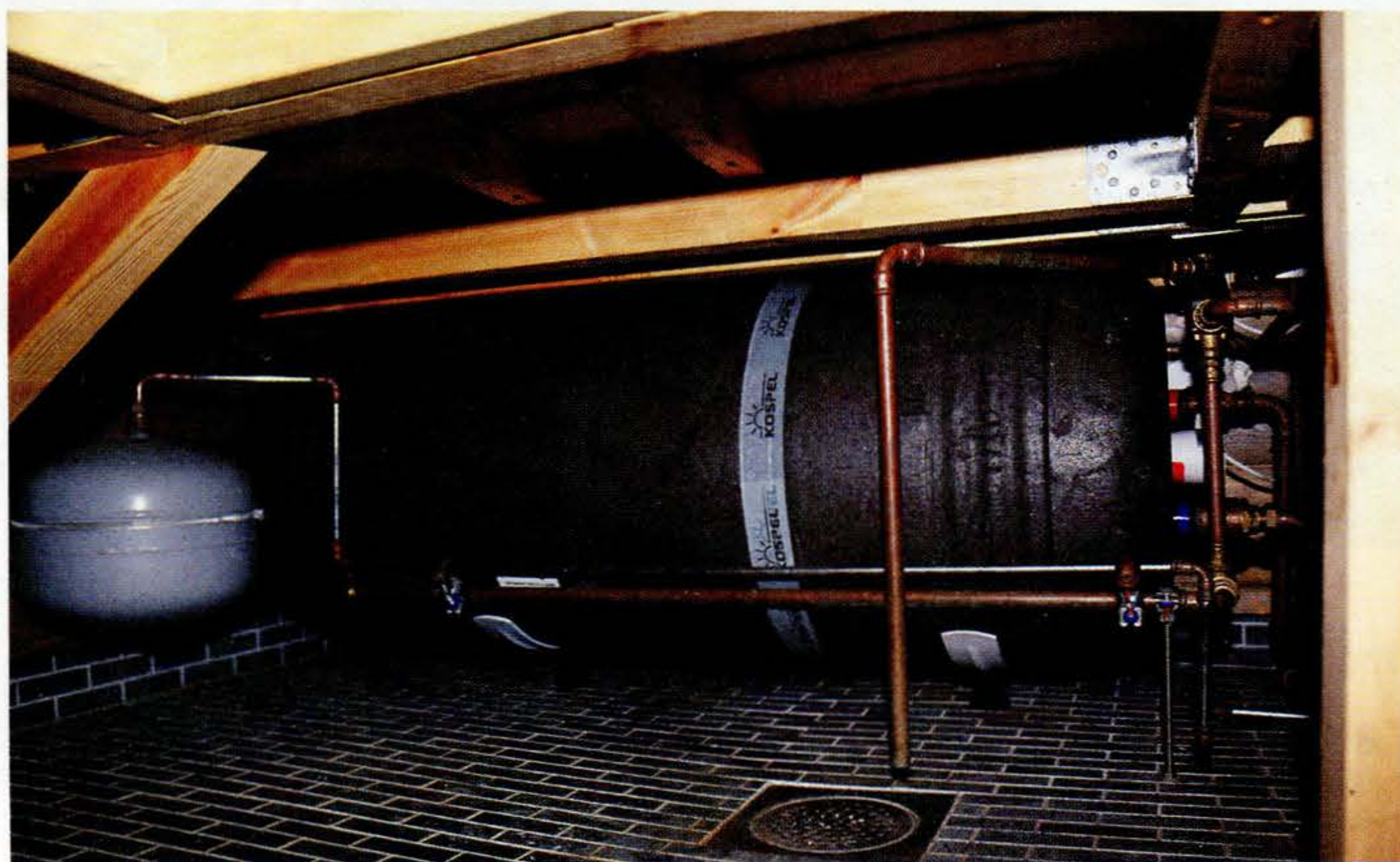
Varaaja on lauteiden alla kiinni seinäkannakkeilla.
