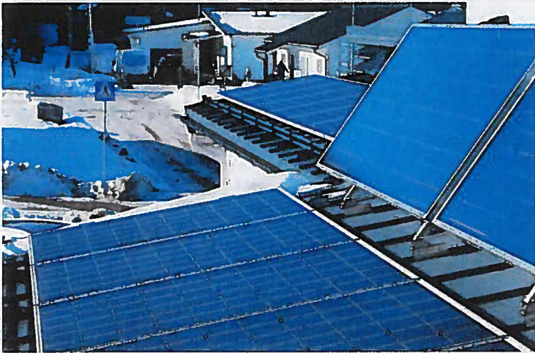
Samassa talossa voidaan hyödyntää sekä aurinkosähköä että aurinkolämpöä. Sähköä tuottavat katon suuntaan sijoitetut paneelit. Lämpöä tuottavat keräimet ovat pystymässä asennossa.
